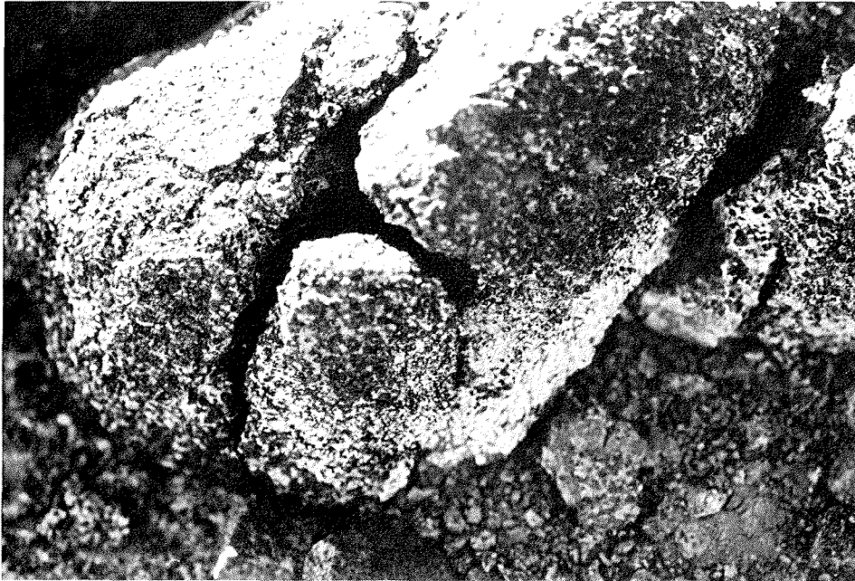
Abb. 6: Im fortgeschrittenen Stadium der Verwitterung brechen manche Steine entlang der inneren Risse auf. Die Abschuppung und Vergrusung entlang der Oberfläche ist ein separater aber gleichzeitiger Prozeß. Der untere Bereich des Steins ist salzbedeckt. Durchmesser des Steins 20 cm. (Roadend Nunatak, 1000 m Höhe).
