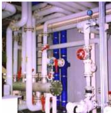
Abbildung 5.8-1: PVDF Rohrnetz: Quelle: Frank GmbH
